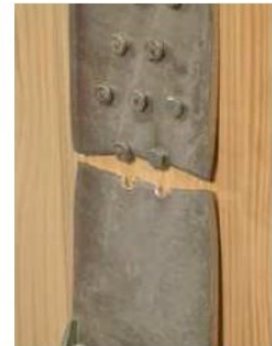
Progettazione in capacità errata
